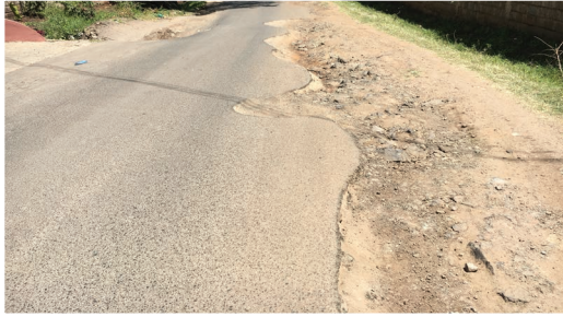
A damaged edge
